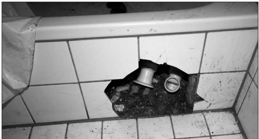
Bei einer der vier Duschen ist der Abfluss defekt.
