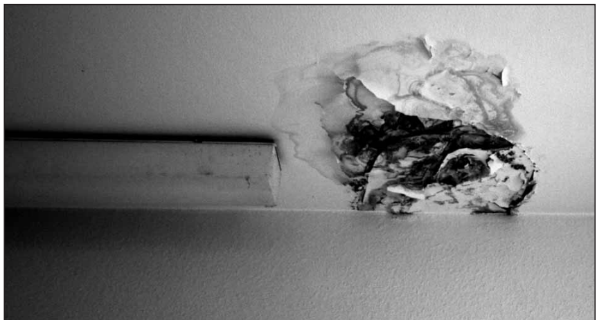
In einer Küche gibt es einen Fleck mit den Folgen eines Wasserschadens an der Decke.
